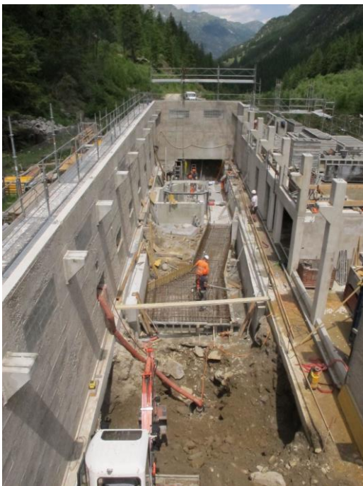
Centrale de Tannuwald
