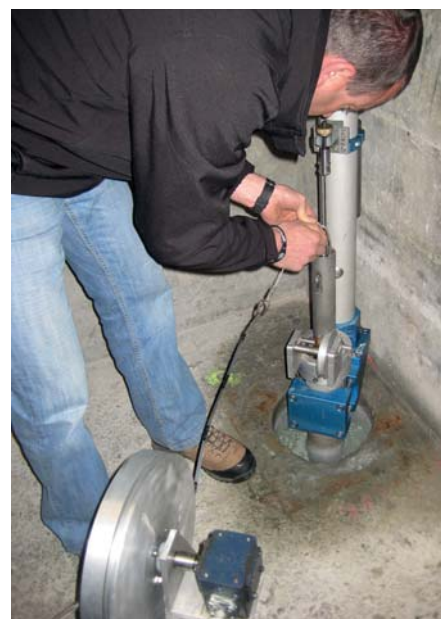
Figura 3. Lettura degli strumenti di controllo nello sbarramento.
